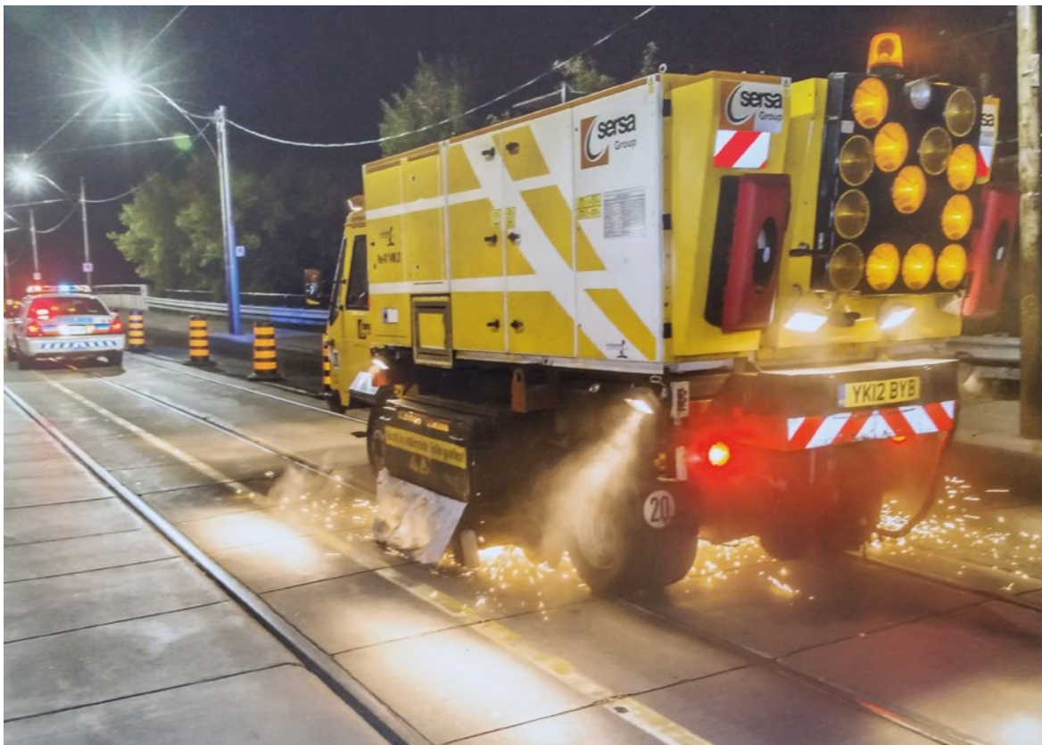
Die „Grail1“ ist dank ihrer geringen Grösse und des schlanken Profils die ideale Schleifmaschine für U- und Stadtbahnen.
