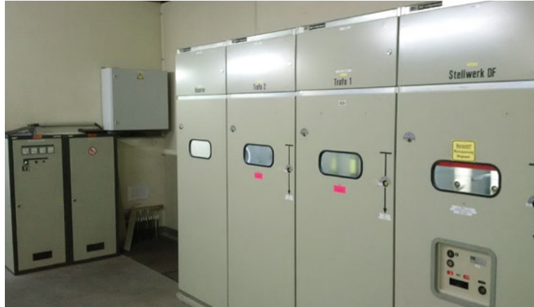
Angekommen: Die neuen Trafos am Hauptbahnhof Düsseldorf.
