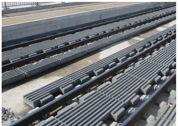
Flexibel und lösungsorientiert hat Rhomberg Sersa die neuen Gleise in Hohenthurm eingebaut.
