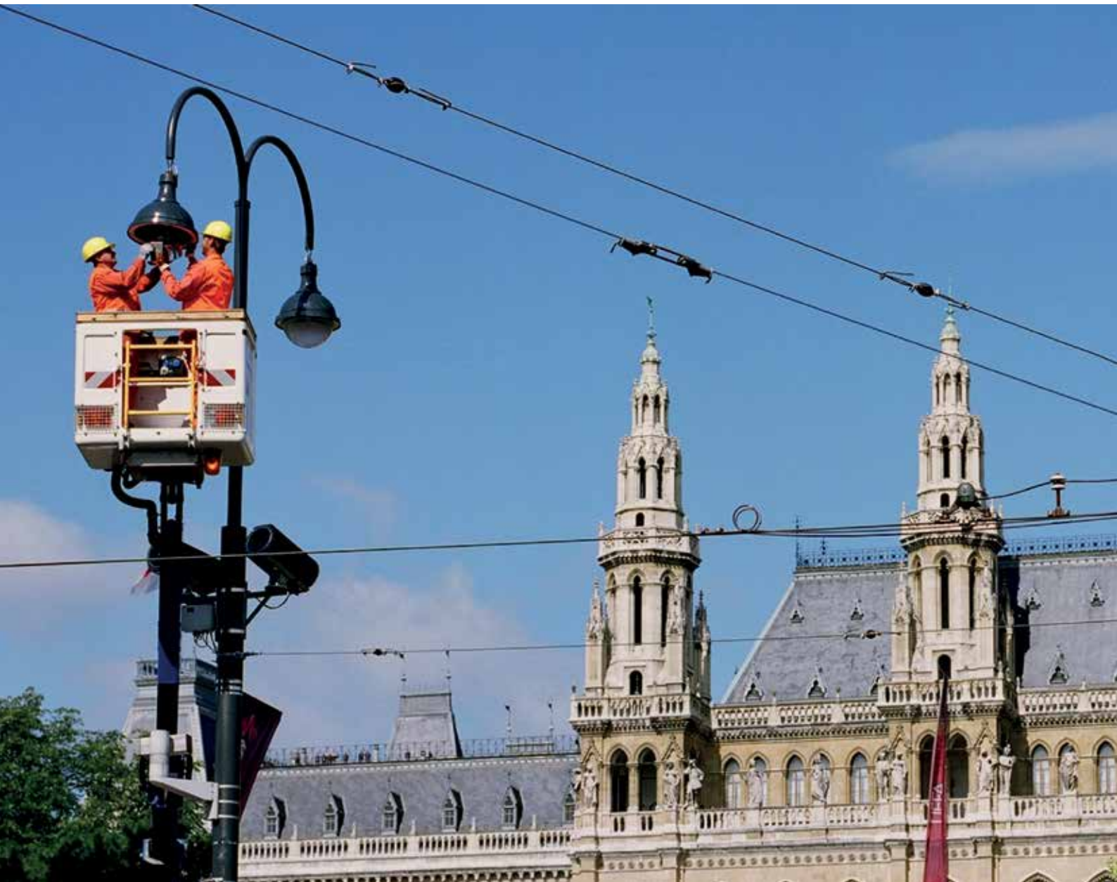
Errichtung der gesamten Strassenbeleuchtungsanlage der Wiener Ringstrasse vor der Kulisse des Wiener Rathauses.
