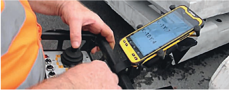
Bild 4: Steuerungsdiskontroll mit Anzeige der Verschiebewerte der kameragestützten Plattenablage
